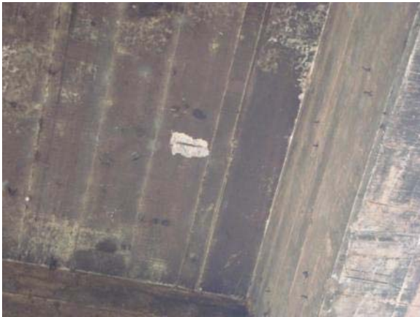
Vista inferior da laje com concreto quebrado com armadura exposta e oxidada.
