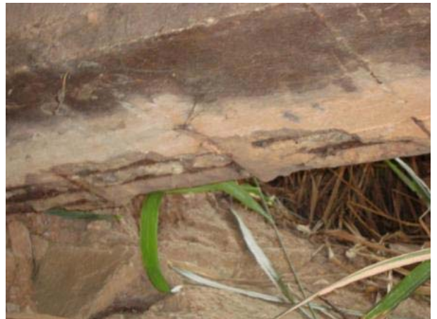
Vista inferior (encontro E2) – longarina lateral direita apoiada no pilar P9D com concreto quebrado e armadura exposta e oxidada.
