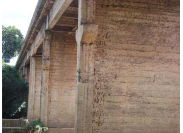
Vista inferior lateral direita - pilar P7D com concreto quebrado e armadura exposta e oxidada.
