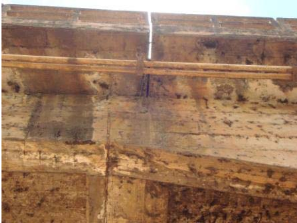
Vista inferior lateral direita – laje em balanço e longarina com escoamento de água devido ausência de pingadeira - Dente Gerber (verificar condições).
