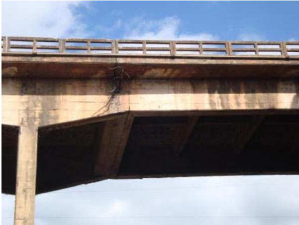
Vista lateral esquerda – laje em balanço e longarina com escoamento de água devido ausência de pingadeira - Dente Gerber (verificar condições).
