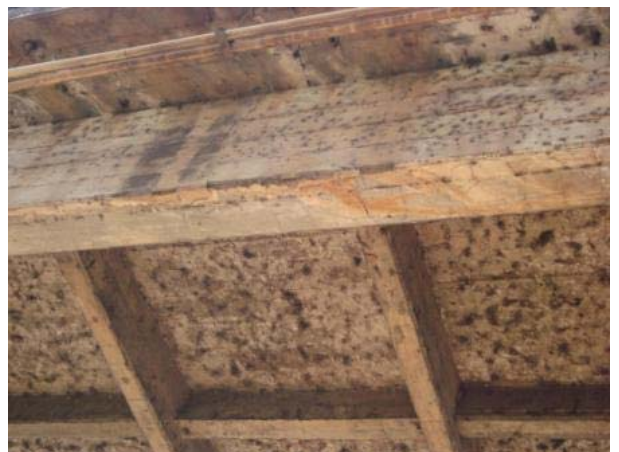
Vista inferior lateral direita – laje em balanço e longarina com escoamento de água devido ausência de pingadeira.
