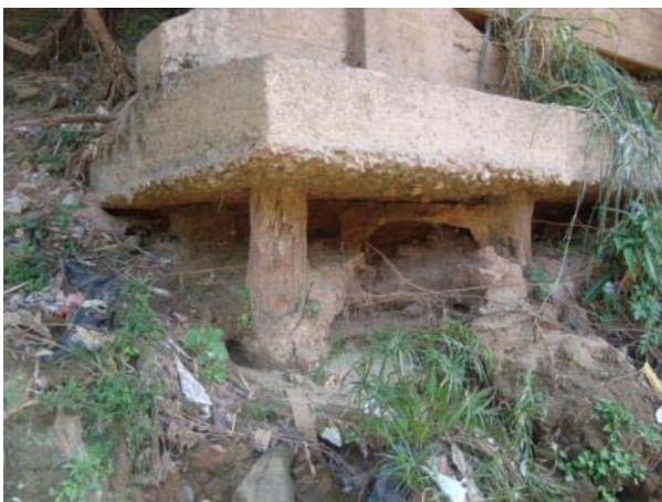
Vista inferior lateral esquerda – vista do pilar P4E com fundação com estacas expostas necessitando de proteção.
