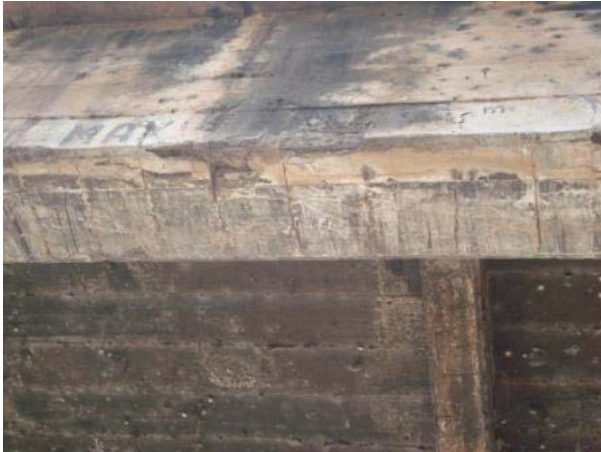
Vista inferior lateral direita - longarina com concreto quebrado, armadura exposta e oxidada, devido colisão de veículos, por causa do gabarito rodoviário vertical baixo.
