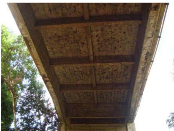
Vista inferior – longarinas laterais, direita e esquerda, com concreto quebrado armadura exposta e oxidada, com brocas ou ninho de concretagem.
