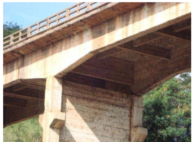
Vista lateral esquerda – laje em balanço com escoamento de água devido ausência de pingadeira.
