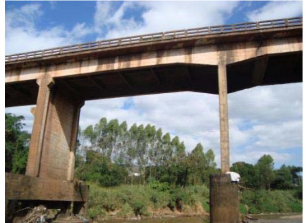
Vista lateral esquerda – laje em balanço e longarina com escoamento de água devido ausência de pingadeira.
