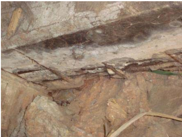
Vista inferior (encontro E2) – longarina lateral direita apoiada no pilar P9D com concreto quebrado e armadura exposta e oxidada.
