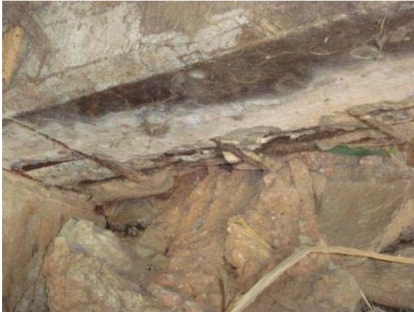
Vista inferior (encontro E2) – longarina lateral direita apoiada no pilar P9D com concreto quebrado e armadura exposta e oxidada.
