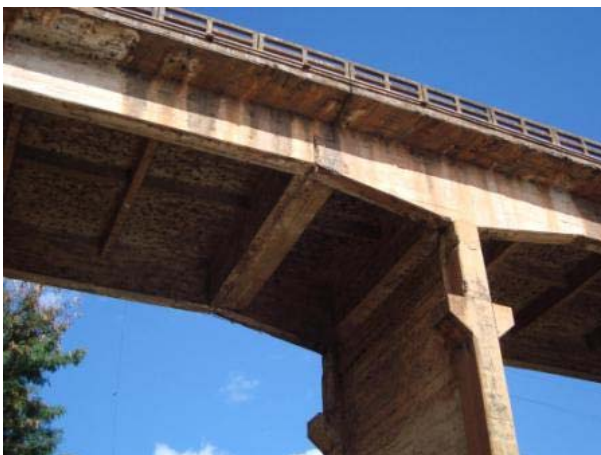
Vista inferior lateral esquerda – longarina apoiada no pilar P7E. Laje em balanço e longarina com escoamento de água devido ausência de pingadeira - Dente Gerber (verificar condições).
