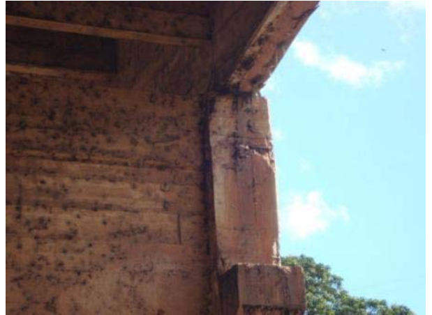
Vista inferior lateral esquerda – longarina apoiada no pilar P8E – pilar e a longarina com armadura exposta e oxidada lateral esquerda
