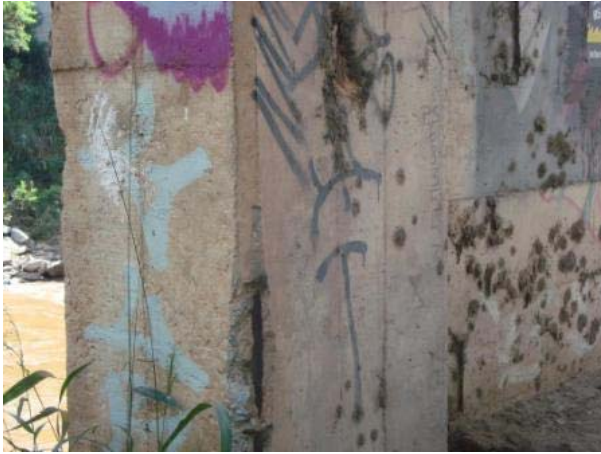
Vista inferior lateral direita - pilar P8D com concreto quebrado e armadura exposta e oxidada.
