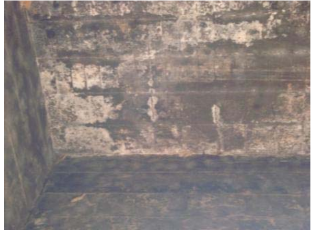
Vista inferior da laje com marcas de carbonatação.
