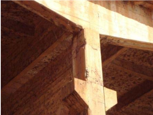
Vista inferior lateral esquerda – longarina apoiada no pilar P7E - Longarina com escoamento de água devido ausência de pingadeira.
