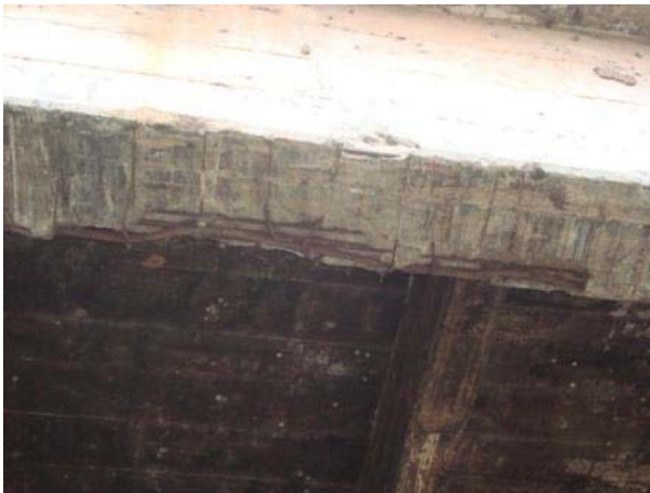
Vista inferior lateral esquerda - longarina com concreto quebrado, armadura exposta e oxidada, devido colisão de veículos, por causa do gabarito rodoviário vertical baixo.
