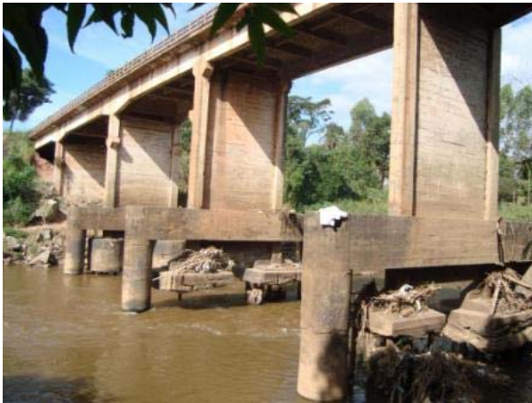
Vista inferior lateral esquerda - detritos acumulados nos elementos, gerando esforços.
