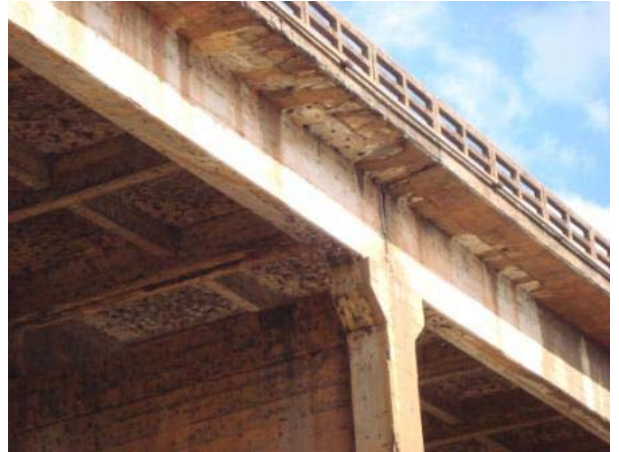
Vista inferior lateral esquerda – longarina apoiada no pilar P6E. Laje em balanço e longarina com escoamento de água devido ausência de pingadeira.
