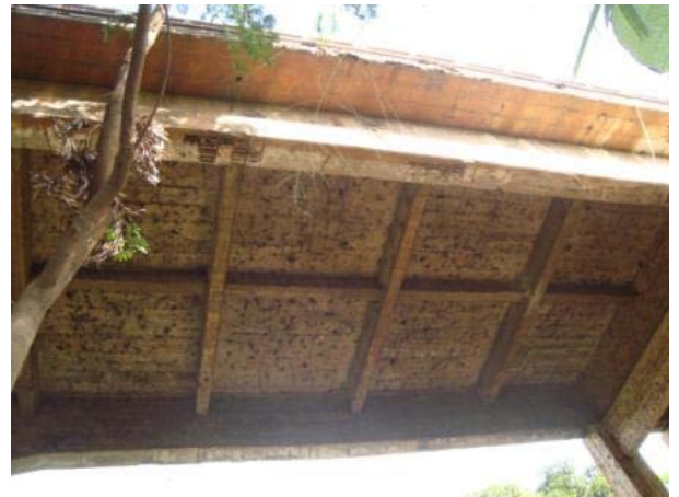
Vista inferior – longarinas laterais, direita e esquerda, com concreto quebrado armadura exposta e oxidada, com brocas ou ninho de concretagem.
