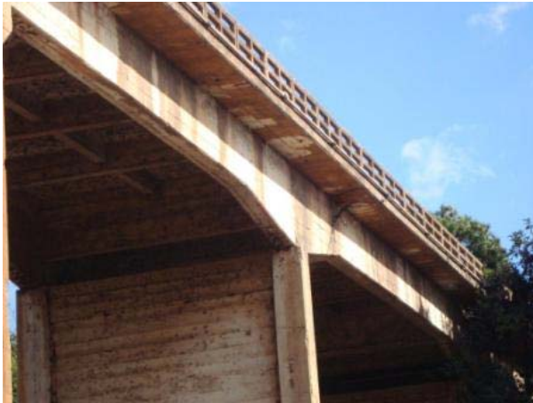
Vista inferior lateral esquerda – longarina apoiada no pilar P5E. Laje em balanço e longarina com escoamento de água devido ausência de pingadeira.
