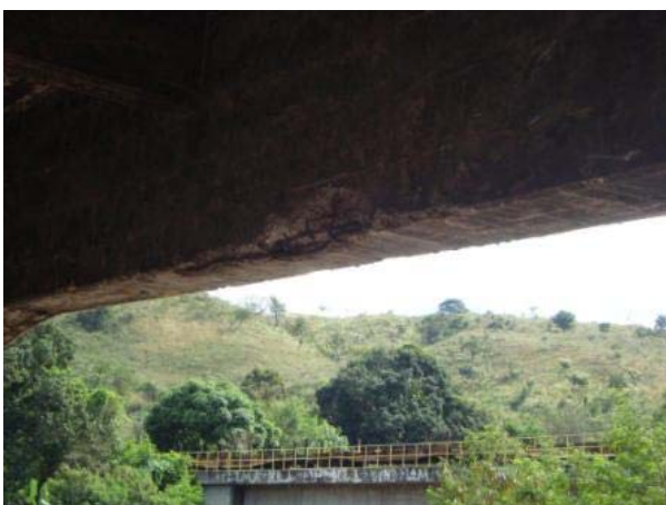
Vista inferior lateral esquerda - longarina com concreto quebrado, armadura exposta e oxidada, devido colisão de veículos, por causa do gabarito rodoviário vertical baixo.
