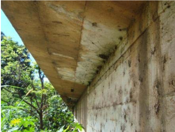
Vista inferior lateral esquerda – laje em balanço com escoamento de água devido ausência de pingadeira.
