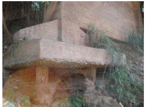
Vista inferior lateral esquerda – vista do pilar P4E com fundação com estacas expostas necessitando de proteção.
