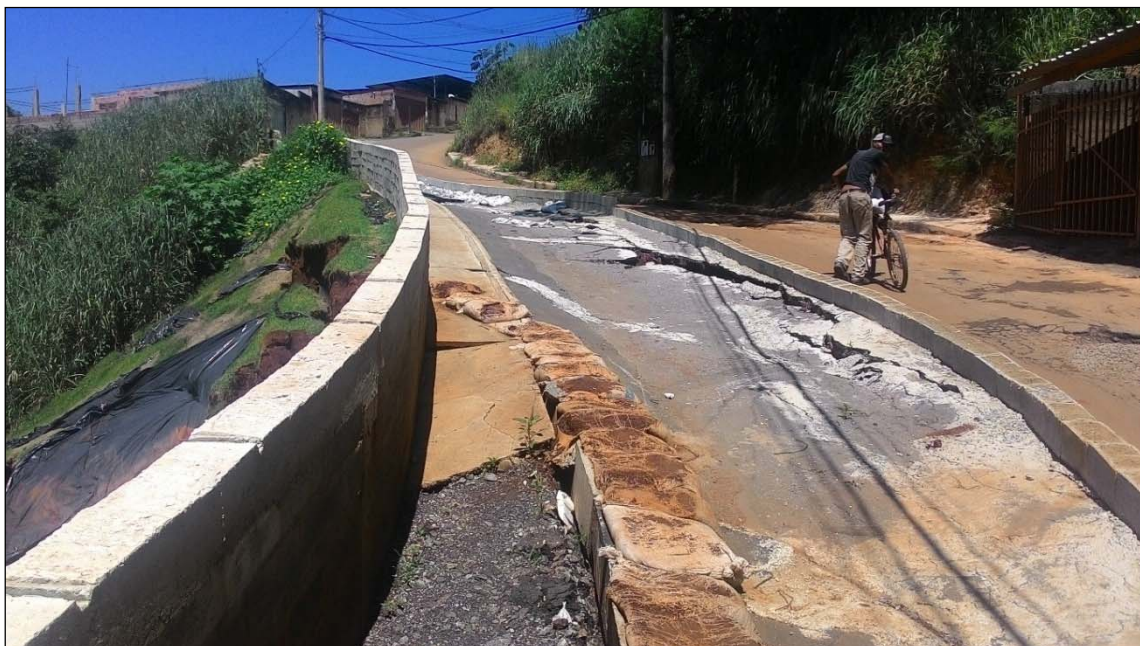
Figura 1: Vista da Rua Embaúba pós rompimento do talude.
