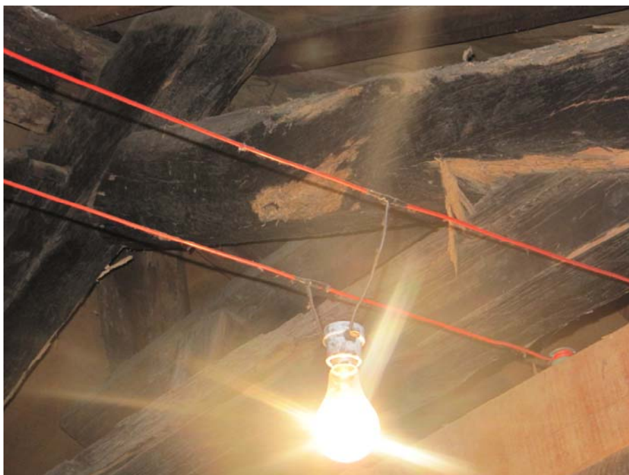
Condutores expostos e presença de conexões improvisadas.
