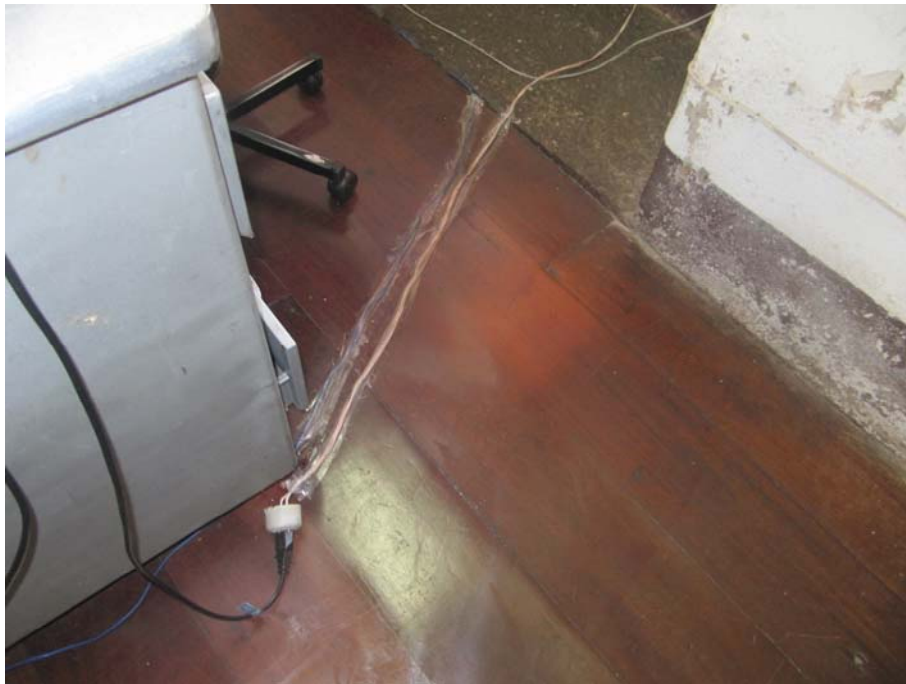
Instalações improvisadas e incorretas.
