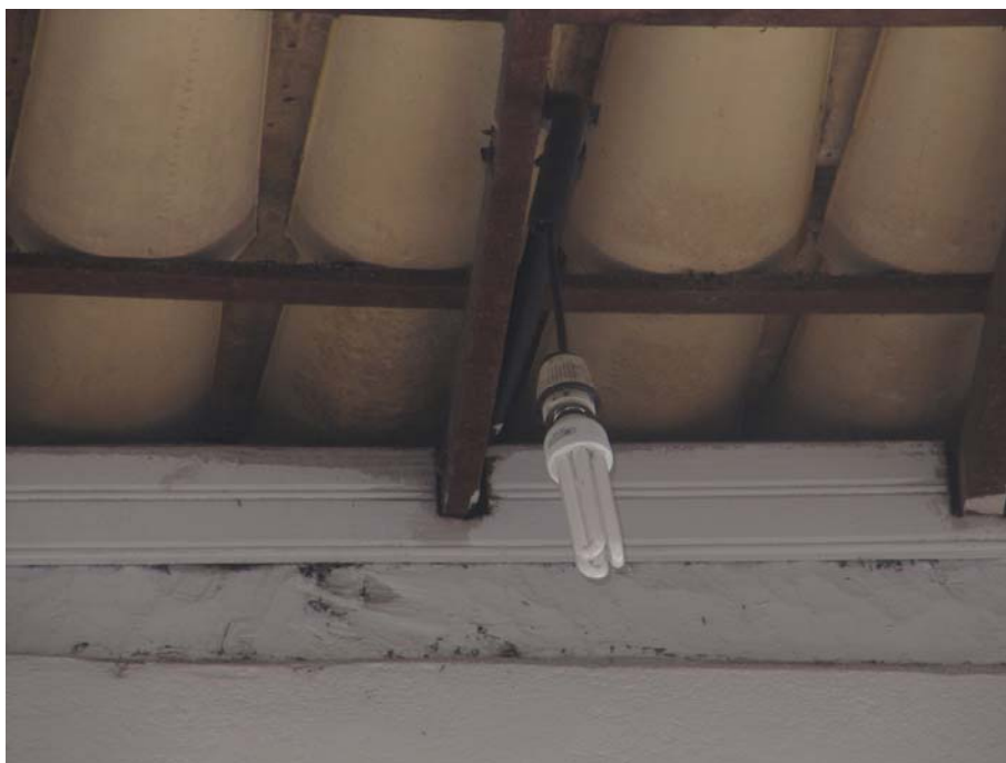
Equipamento de iluminação inadequado e mal instalado.
