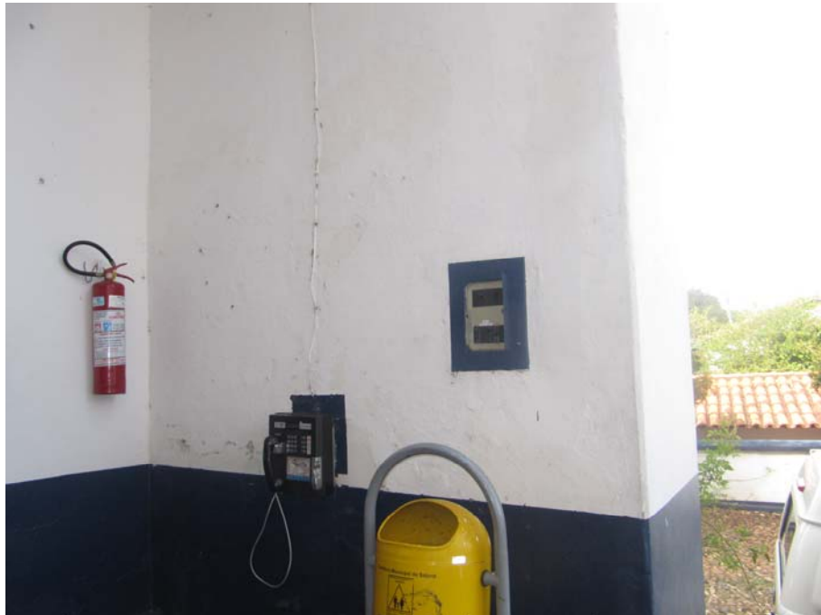
Quadro de disjuntores desatualizado.
