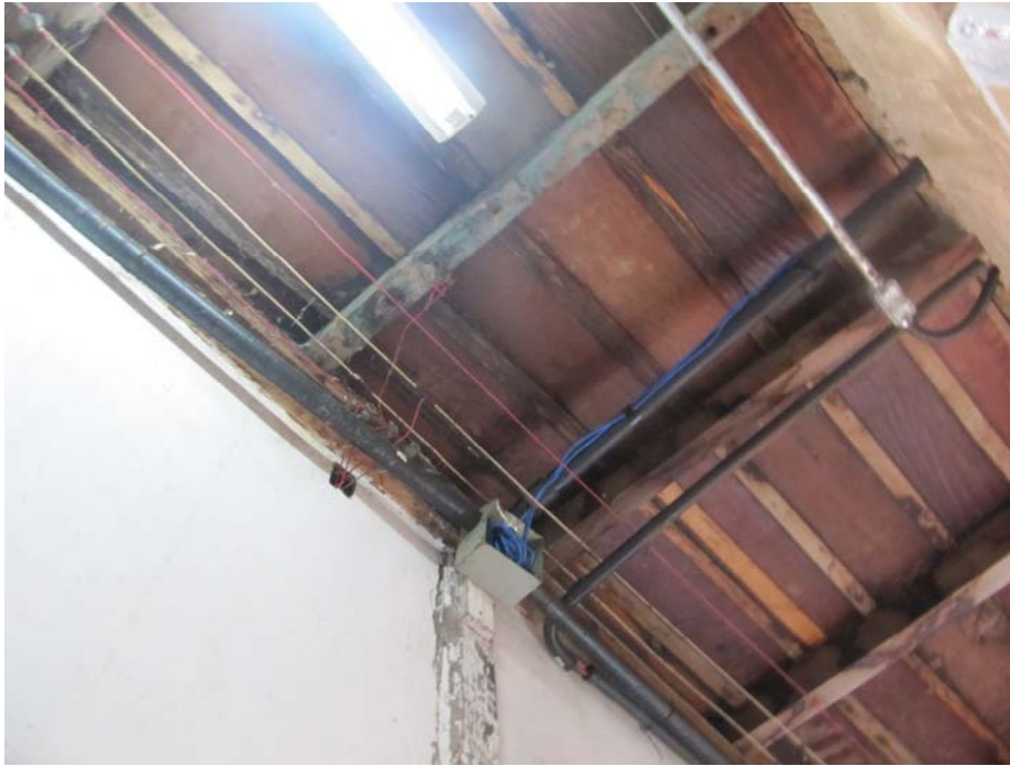
Condutores expostos, sem padronização e com conexões incorretas.
