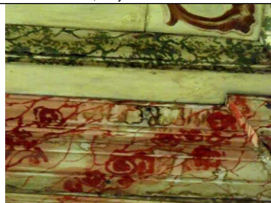
Figura 53: Roda Teto - Manchas de umidade.
