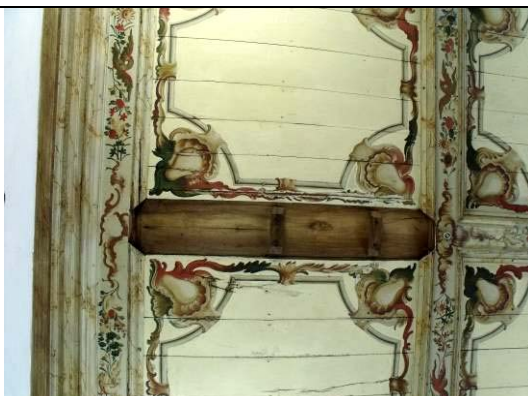
Figura 78: Entorno dos caixotões: Perda de uma das tábuas entre os caixotões e molduras.
