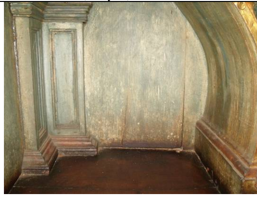
Figura 42: Lateral direita, pequenas perdas da policromia, manchas de materiais de limpeza e deslocamento de bloco com preenchimento resultado de intervenção anterior. Autor/Data: Lara, Elayne, 2013.
