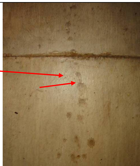
Figura 44: Detalhe das manchas e deslocamentos.
