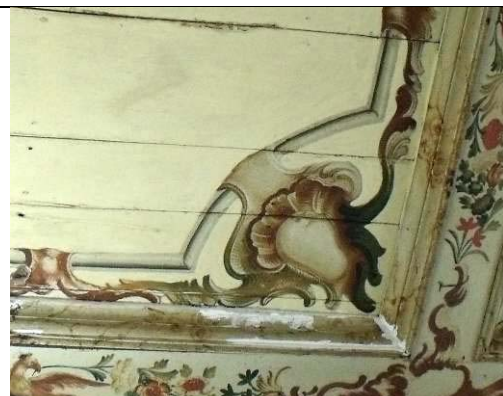
Figura 79: Entorno dos caixotões: Intervenções anteriores com massa branca, fechamento de fendas.
