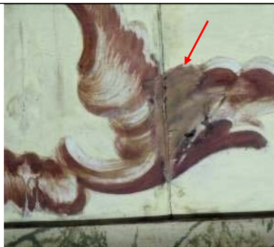
Figura 65: Reintegração cromática, intervenção anterior de forma inadequada na área das tábuas entre os caixotões.
