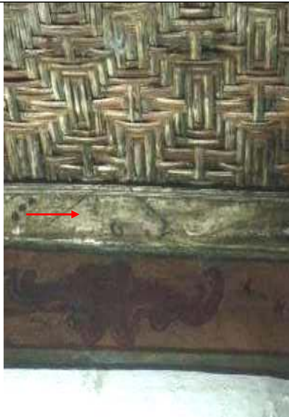
Figura 127: Rodaforro com presença de excrementos de insetos xilófagos. Perda da policromia com base de preparação aparente.
