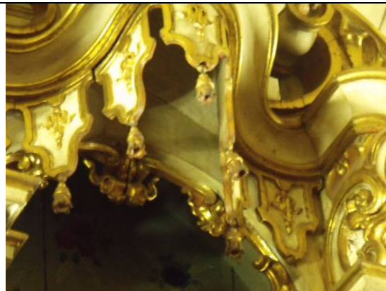
Figura 26: Perda do pingente na lateral direita no dossel do coroamento do retábulo.
