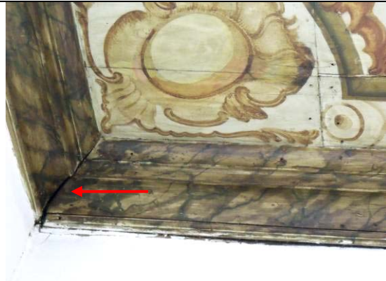
Figura 89: Roda Teto - Deslocamento da moldura no canto, deixando frestas e desnível.
