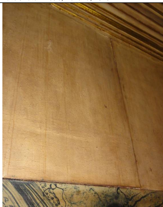
Figura 45: Presença de manchas de infiltrações descendentes e tábuas deslocadas no revestimento da Capela.
