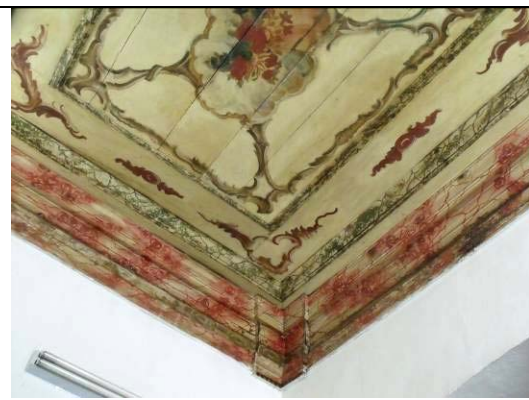
Figura 60: Canto com demonstração de roda teto, tábuas que dividem os caixotões e caixotão 2
