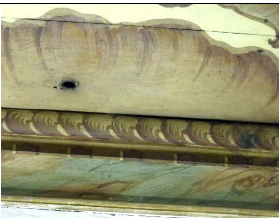
Figura 116: Tábuas do Forro - Furo. Manchas de tinta branca.
