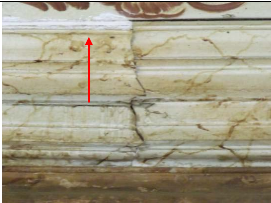
Figura 76: Roda Teto - Intervenções anteriores com massa branca, parecendo ser um início de fechamento de fendas na junção da 3ª faixa no lado esquerdo da porta.
