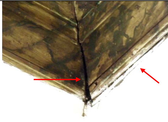
Figura 90: Roda Teto - Deslocamento da moldura, criando frestas. Manchas de tinta branca (recente) na moldura próxima à parede.
