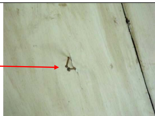
Figura 106: Tábuas do Forro – Presença de pregos. Manchas na pintura de fundo proveniente de intervenções anteriores.
