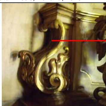
Figura 33: Lateral esquerda. Rachadura e deslocamento de blocos. Autor/Data: Lara, Elayne, 2013.
