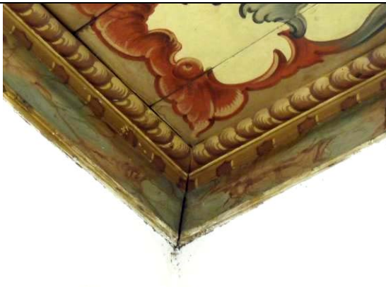
Figura 113: Roda Teto - Deslocamento da moldura no canto, deixando grandes frestas.
