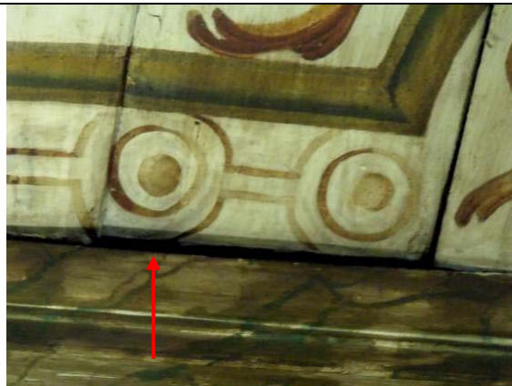
Figura 96: Tábuas do Forro: Deslocamento das tábuas, ocasionando frestas, com leve abaulamento da tábua.
