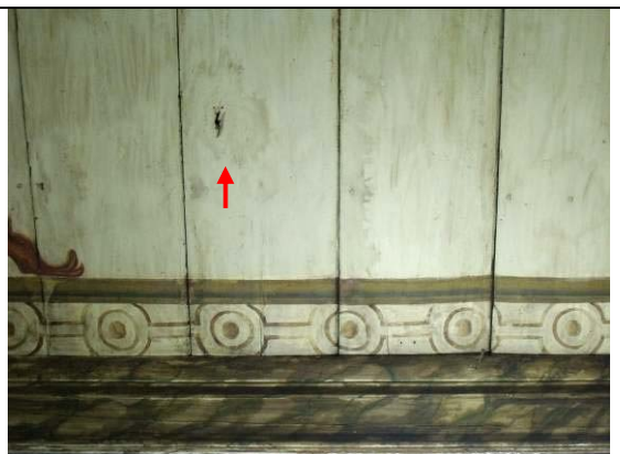
Figura 100: Tábuas do Forro: Manchas de umidade e oxidação.
