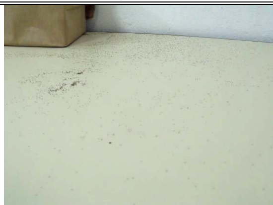
Figura 93: Presença de excrementos de insetos xilófagos sobre as mesas. Cupim ativo.
