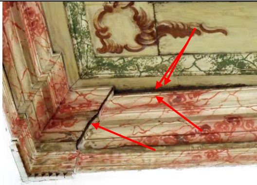
Figura 51: Roda Teto - Deslocamento de blocos com frestas e desnível nas junções das molduras. Perdas com consolidações anteriores inadequadas mal planificadas com material escuro de aspecto grotesco.
