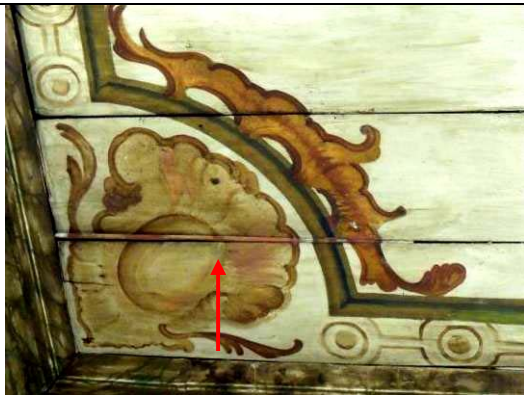
Figura 101: Tábuas do Forro: Presença de filete de preenchimento de frestas e manchas generalizadas na pintura de fundo, provenientes de intervenções anteriores.
