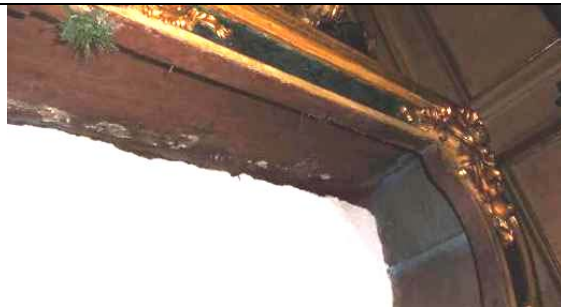
Figura 22: Na parte interna da base, pequenas galerias causadas por cupins.
