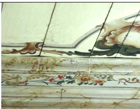
Figura 83: Manchas de umidade
