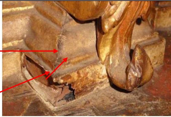
Figura 20: Perda sob uma das pilastras do Sacrário, causada pela ação de cupins.
