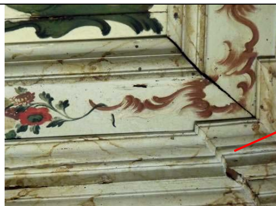
Figura 73: Roda Teto - Pequena perda na moldura da 3ª faixa no canto do lado direito da porta;
