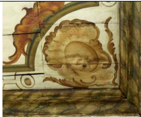
Figura 104: Tábuas do Forro: Manchas de oxidação e umidade. Deslocamento das tábuas, deixando pequenas frestas.
