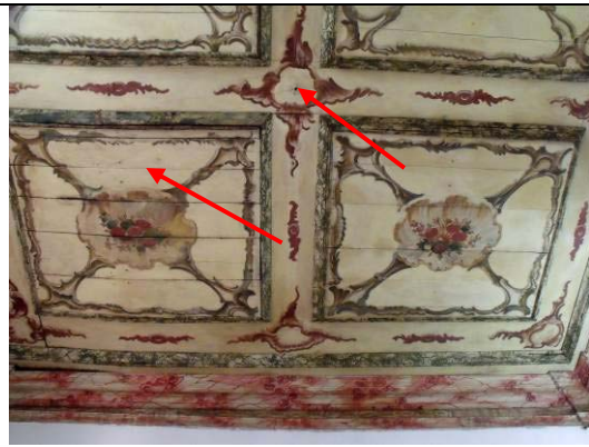
Figura 58: Caixotão 3 e 4 –Manchas de umidade, manchas de oxidação, frestas, intervenções com alteração de cor.
