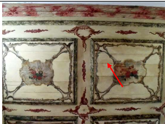
Figura 57: Caixotão 1 e 2 –Manchas de umidade, manchas de oxidação, frestas, intervenções com alteração de cor.
