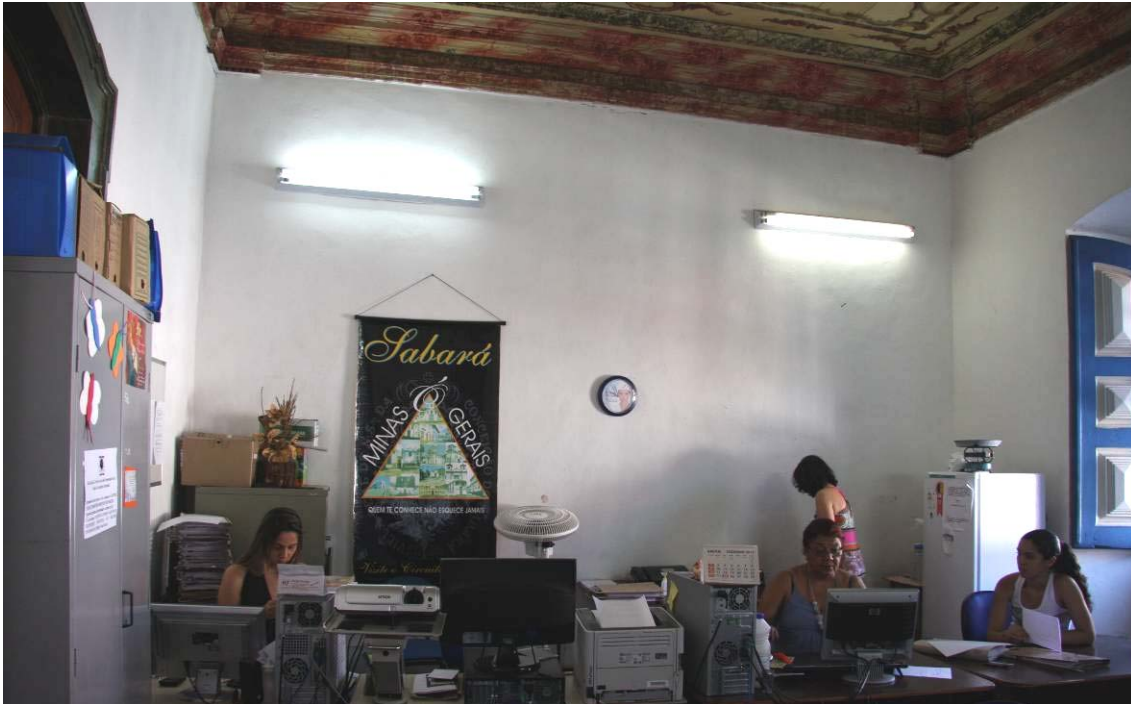
Figura 49: Contextualização do Forro do Cômodo 3 – Vista geral. Autor: Assis, Adriana, janeiro de 2013.
