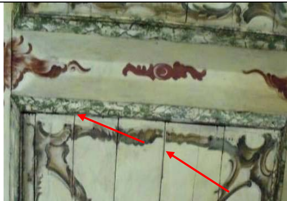
Figura 63: Caixotão 3 - Perda de filete, rachaduras principalmente nas extremidades das tábuas, manchas de oxidação geradas por pregos ou cravos.
