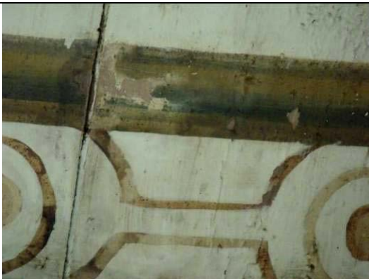
Figura 103: Tábuas do Forro: Perda da policromia. Manchas generalizadas na pintura de fundo, provenientes de intervenções anteriores. Deslocamento das tábuas, deixando frestas.
