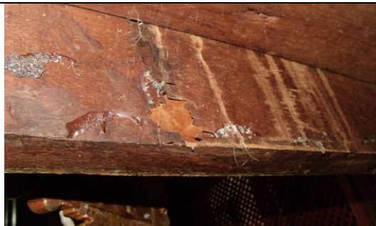
Figura 21: suporte da base com teias de aranha, galerias de cupins, manchas de umidade.
