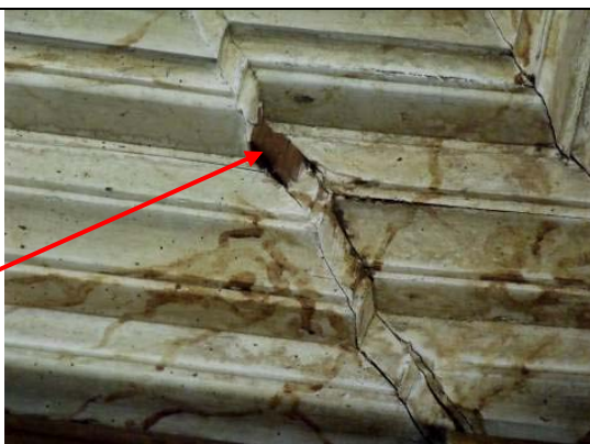
Figura 74: Roda Teto - Pequena perda na moldura da 3ª faixa no canto do lado direito da porta;
