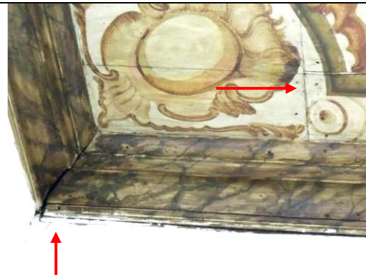
Figura 102: Roda Teto e Tábuas do Forro: - Sobreposição de tinta branca recente na moldura. Manchas de oxidação ocasionadas pela presença de cravos ou pregos.
