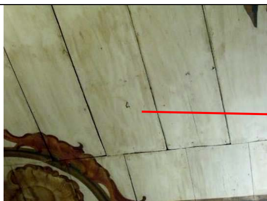
Figura 105: Tábuas do Forro – Presença de pregos. Manchas na pintura de fundo proveniente de intervenções anteriores.
