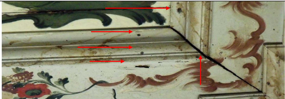
Figura 75: Roda Teto - Manchas de oxidação e furos causados por pregos ou cravos. Deslocamento de blocos, principalmente nas junções dos cantos, deixando frestas;
