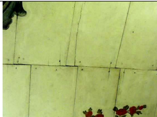
Figura 114: Roda Teto - Rachaduras nas extremidades das tábuas.
