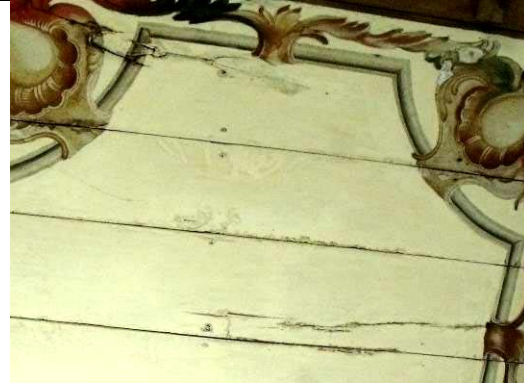
Figura 81: Rachaduras, manchas de umidade.
