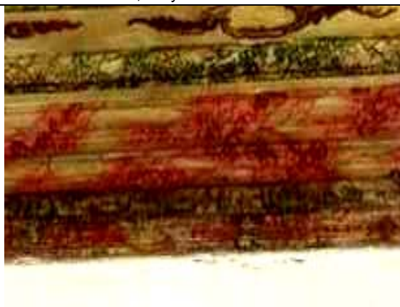
Figura 55: Roda Teto - Intervenção anterior que não segue o desenho original da faixa decorativa, feito de forma grosseira.
