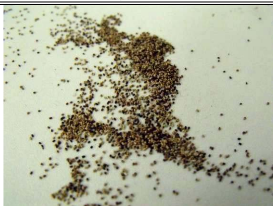
Figura 94: Presença de excrementos de insetos xilófagos sobre as mesas. Cupim ativo.
