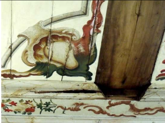
Figura 80: Ataque de insetos xilófagos com galeria expostas. Manchas de umidade.
