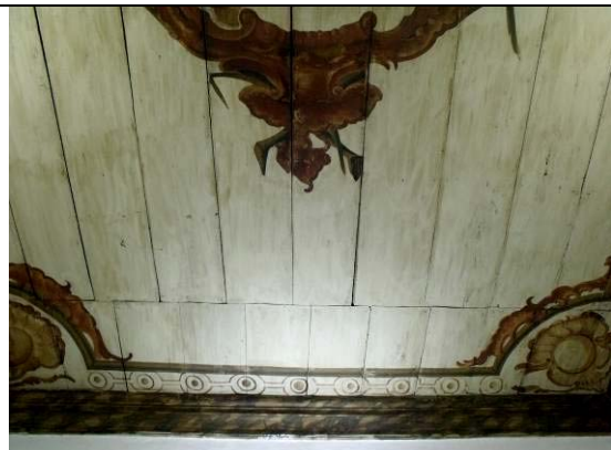
Figura 97: Tábuas do Forro: Área de emenda das tábuas. Manchas generalizadas na pintura de fundo, provenientes de intervenções anteriores.
